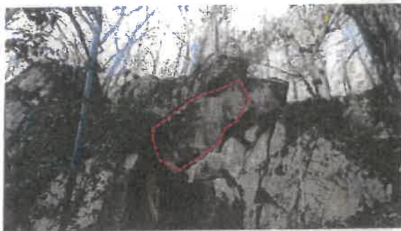
Vue des 2 masses instables depuis le bas de l'escarpement
