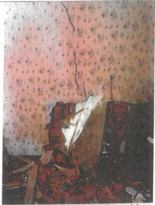
Mur en briques transpercé au niveau de l'entresol du premier niveau de la construction
