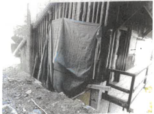
Protection avant reconstruction du mur de la façade amont. Fissuration de la bâtisse en façade sud.
