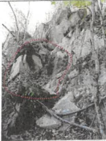
Zone de départ de l'instabilité du 10.08 estimée à 9 m 3
